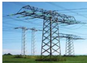
Vedení 2x110 kV. Stožár „Podchodový“ Double 110kV line. “Low-profile” tower
