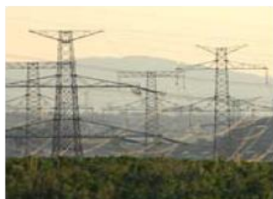
Dvojité vedení 2x400 kV. Stožárová konstrukce „Dunaj“ Double 400kV line. “Donau” tower
