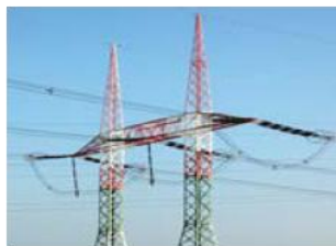
Stožárová konstrukce „Portál“, typ kotevní, opatřená leteckým bezpečnostním nátěrem “Portal” anchor tower with an aircraft protection coating
